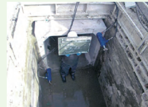
ボックスカルバートの緊結 PC 鋼棒に緊張力を与え、ボックスカルバート同士を一体化させます。
