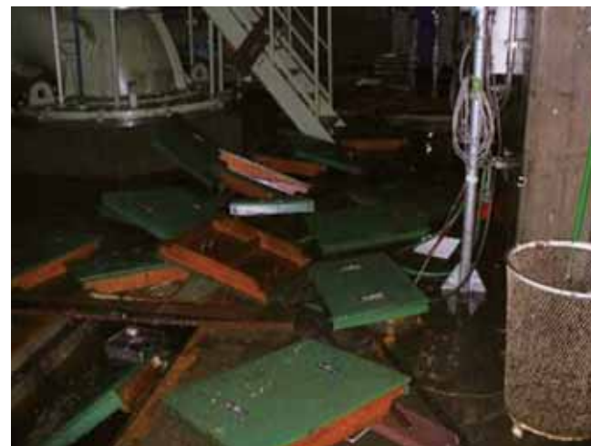
冠水したポンプ設備
