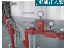
重油注入装置
