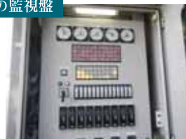
屋外の監視盤
