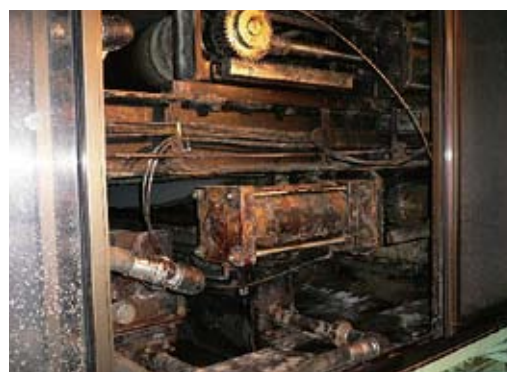
写真4 ベルトプレス脱水機内部
