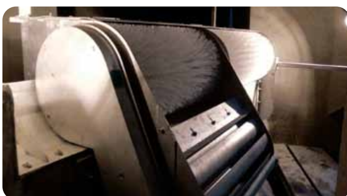
「写真3」平成21年8月に設置した無動力タイプのスクリーン
