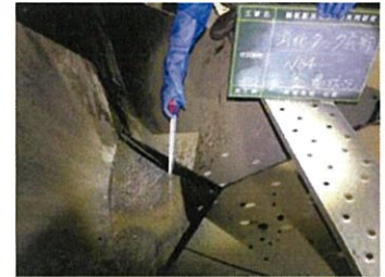
写真-2 引抜口堆積状況
